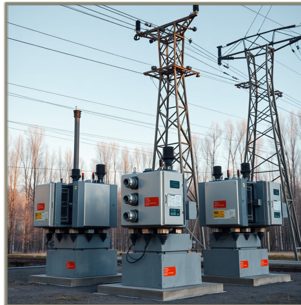
Автоматизация управления разъединителями
