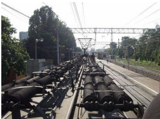
Рис. 1.14 Тормозные резисторы на крыше моторного вагона электропоезда ЭР2Р.
